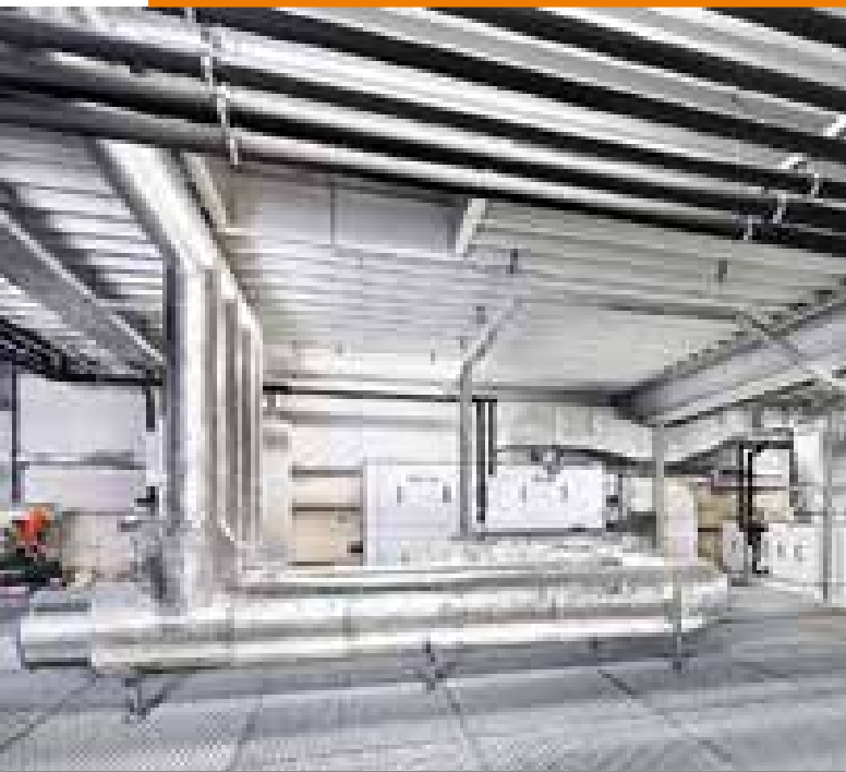
RLT-Zentrale im TROX Zentralgebäude.
