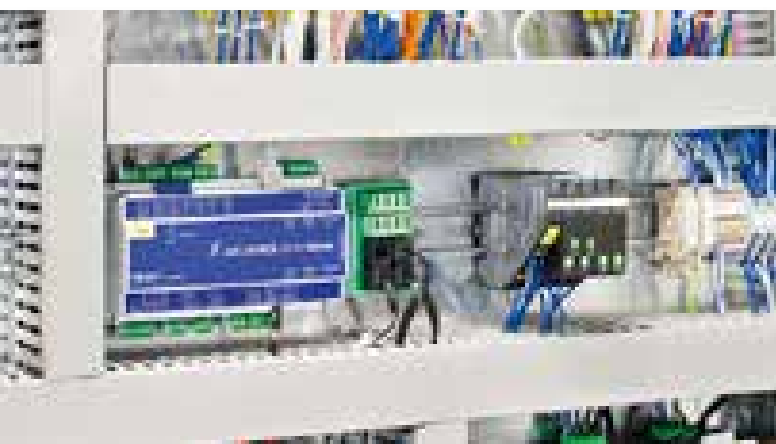
Dank funkgesteuerter Regeltechnik wird bedarfsgesteuert belüftet und klimatisiert.
